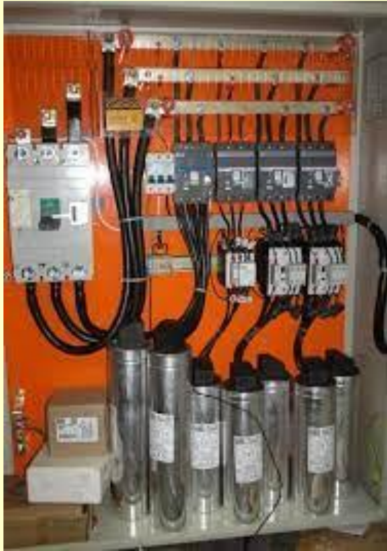
Condensadores para corrección del factor de potencia
